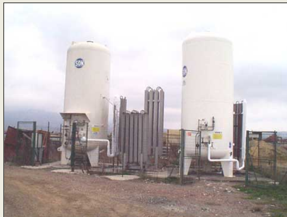
Serbatoi di ossigeno liquido
